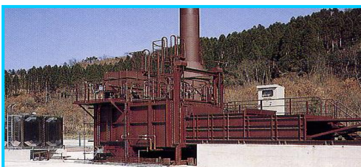
流木・浮遊物焼却炉
